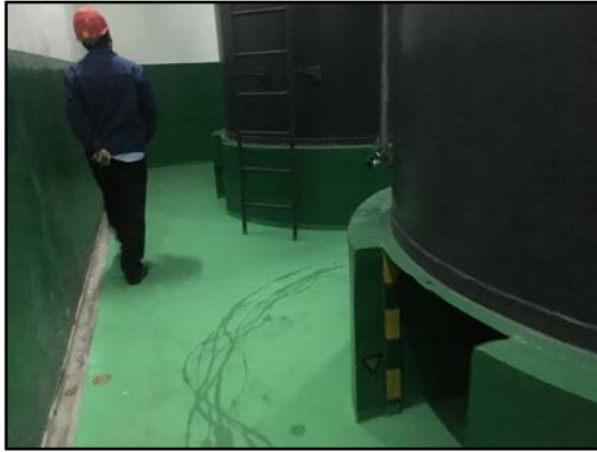
油罐区及地面导流槽
