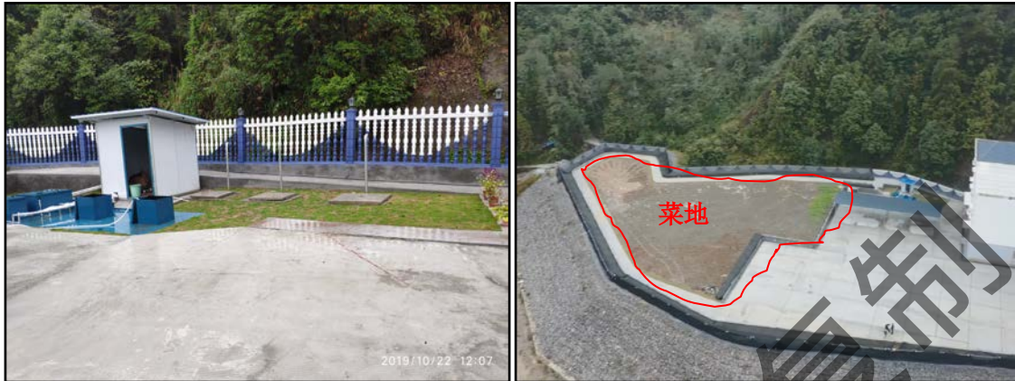
生活区地埋式一体化污水处理装置
